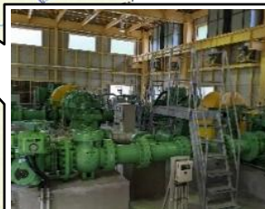
世増揚水機場
