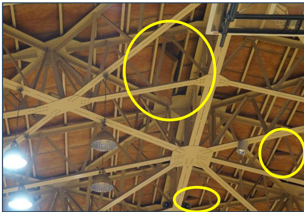
屋根断熱材多数剥離
