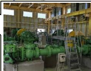
世増揚水機場
