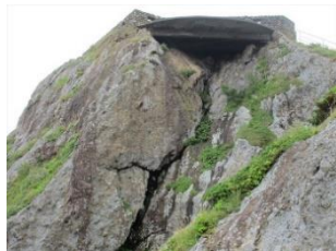
<破損箇所が見える状態>
