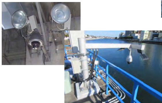
②監視カメラ設備（設置例）
