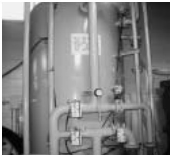
汚染拡散防止の仮設浄化プラント
