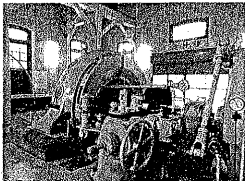
現在稼働中の水力発電機
