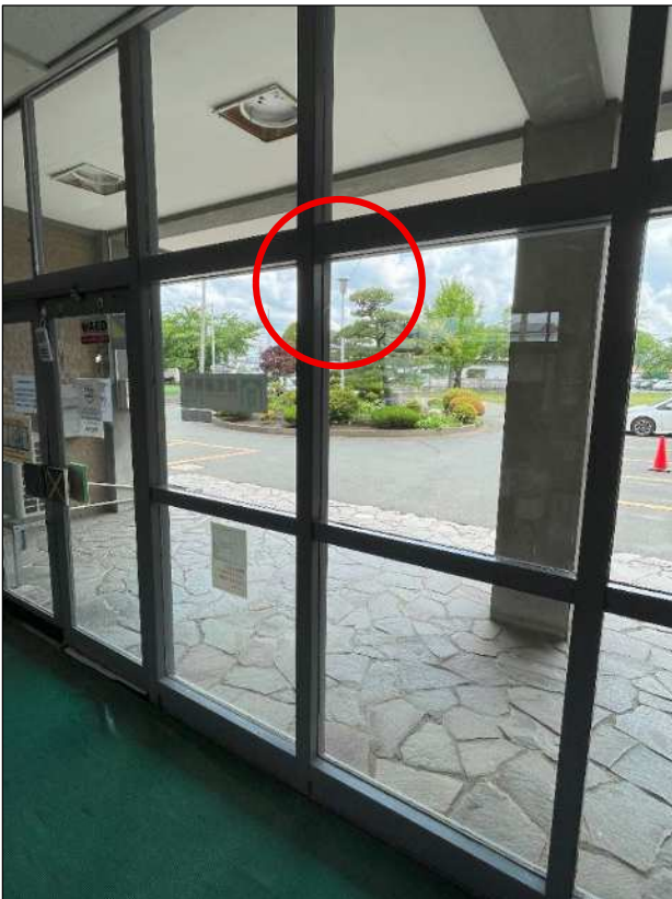
玄関 窓ガラス
