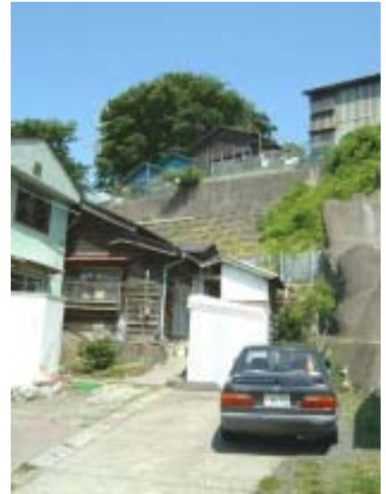
湊地域の急傾斜地崩壊危険区域
