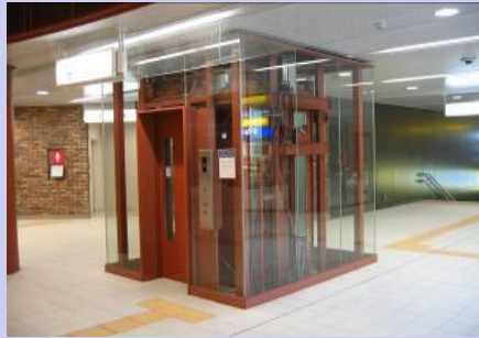
エレベーター
