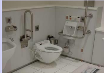
障害者対応型トイレ
