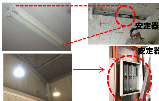
蛍光灯・水銀灯の安定器
