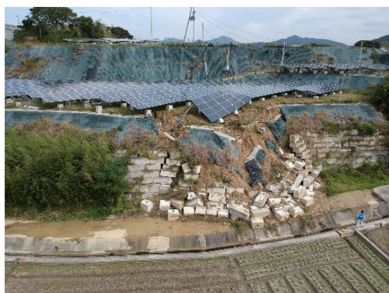
■法面の崩壊が発生し、法面保護工が崩れて流出した事例（出典：「地上設備型太陽光発電システムの設計ガイドライン2019年版」）
