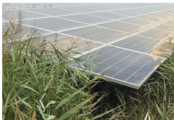
■台風時の水害により施設が水没した事例（出典：事業者提供）
