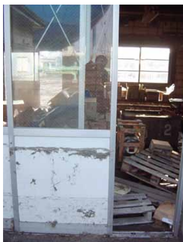
資材倉庫の被害状況
