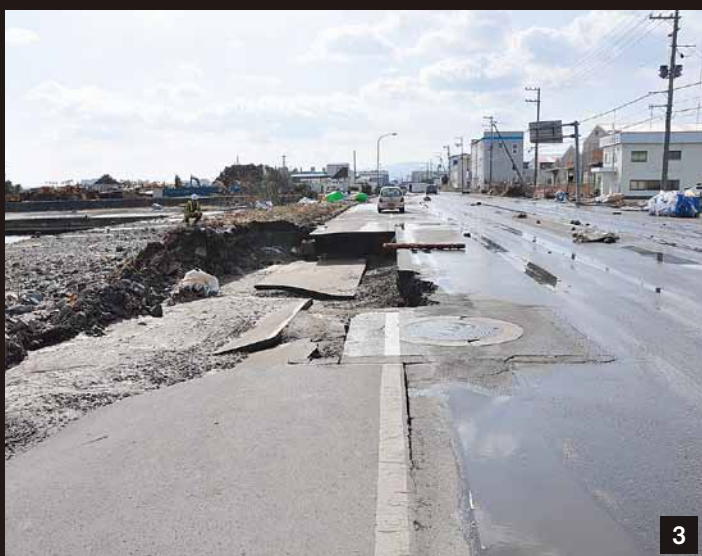
3／八太郎 1号埠頭付近の被害の様子 (平成23年3月12日撮影) 4／復旧後の様子 (平成23年11月撮影)
