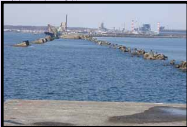
被災直後の状況
