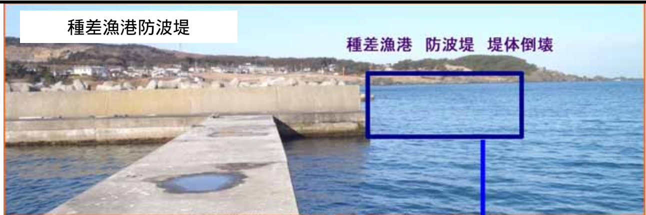
種差漁港 防波堤 堤体 復旧前
