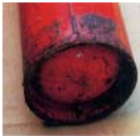
溶接部及び その周辺の剥離
