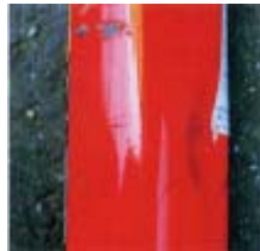
使用に耐えない変形
